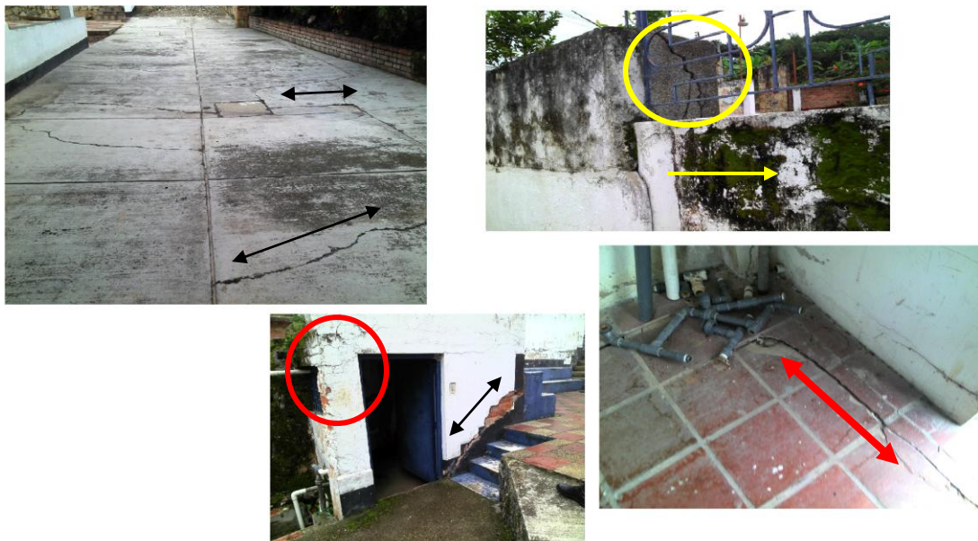
Imagen 2. Grados de exposición y agrietamientos en los materiales que conforman las instalaciones. Fuente propia
