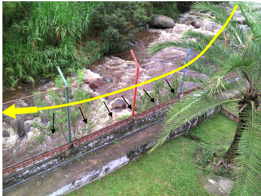
Fotografía 1. Sinuosidad del río que ocasiona fenómenos de socavación sobre el material que conforma la base el muro de contención en contacto. Fuente propia.
