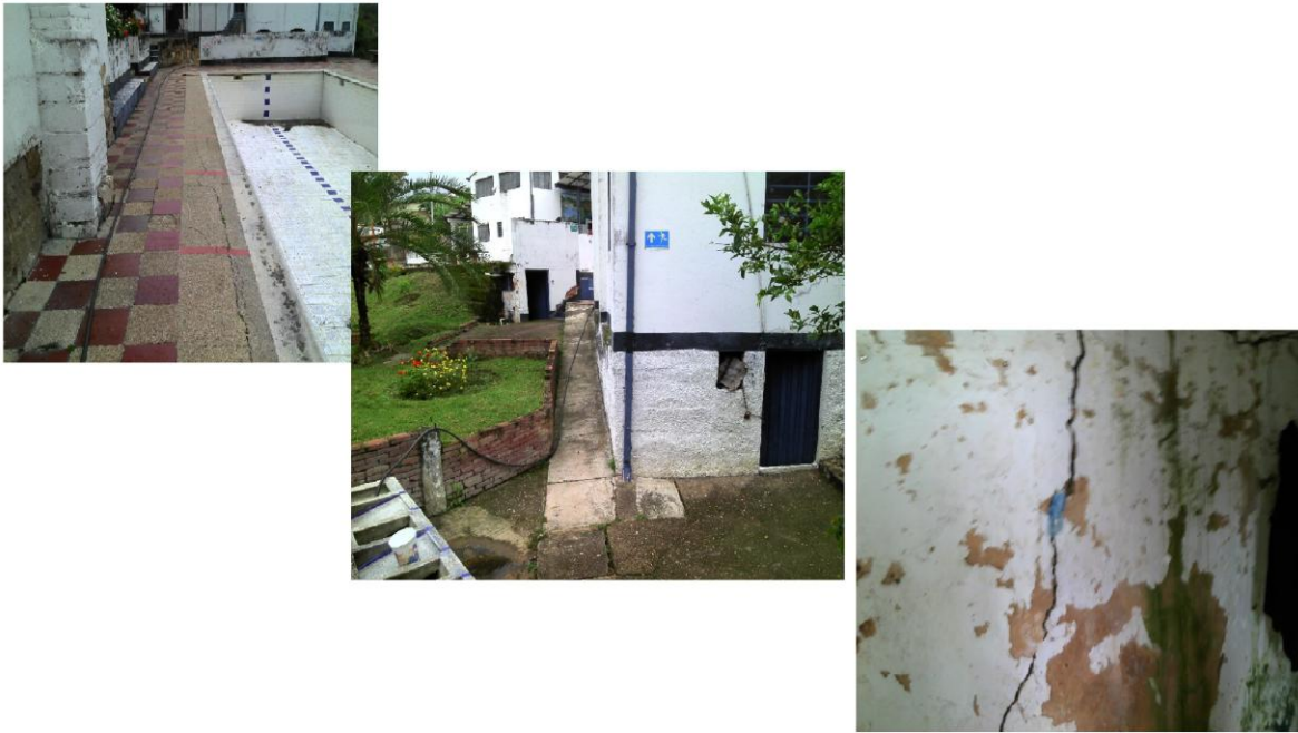
Imagen 1. Espacios de las instalaciones dedicados a uso recreativo y habitacional en alto grado de deterioro. Fuente propia
