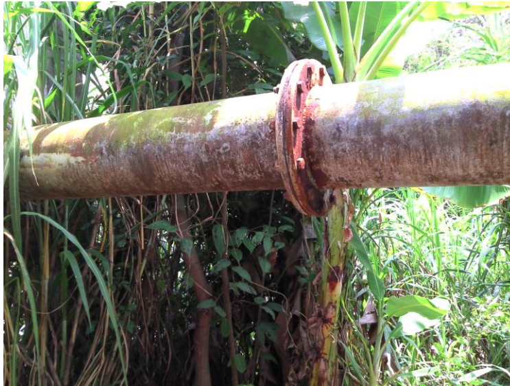
Fotografía 3. Conexiones de Tubería que transporta las aguas sobre el río Bogotá, para el abastecimiento de los municipios de Agua de Dios y Tocaima.
