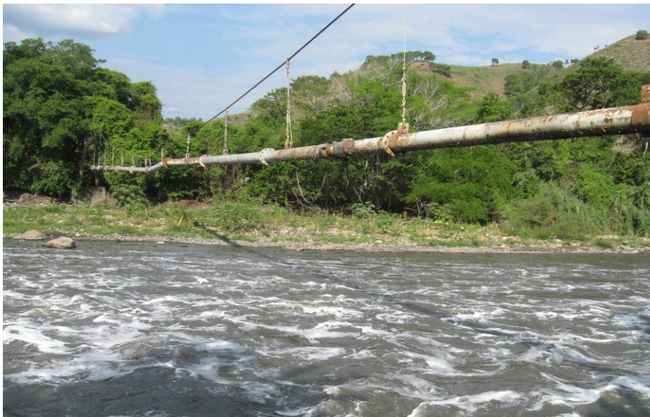
Fotografía 1. Tubería que transporta las aguas sobre el río Bogotá, para el abastecimiento de la misma en los municipios de Agua de Dios y Tocaima, por la empresa INGEAGUAS S.A- E.S.P
