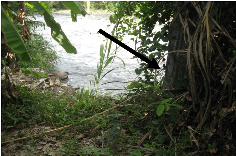
Fotografía 2. Inclinación de los soportes estructurales debida a socavación e inestabilidad del material de cimentación.
