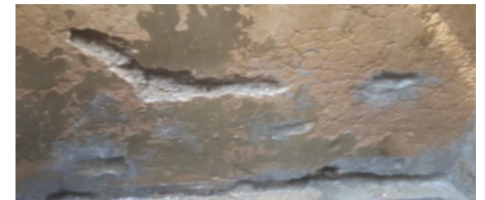
Foto 15. Hormigueros en muro de tanque.
