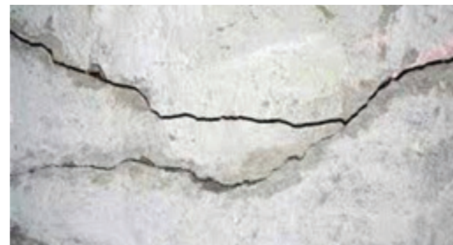
Foto 32. Grietas en superficie muro de concreto
