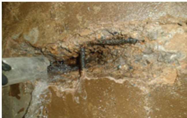
Foto 30. Infiltración de agua por nivel freático
