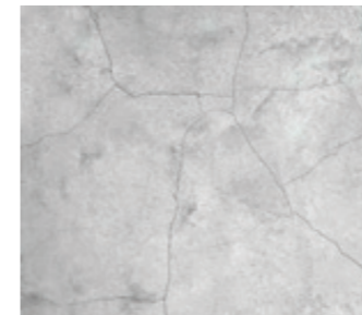
Foto 20. Fisuras en la superficie del concreto
