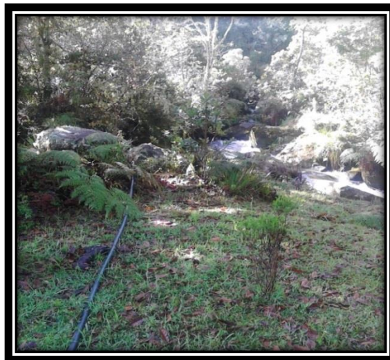
Figura 8. Fotografía quebrada Otero, mangueras superficiales expuestas al paso de animales.
