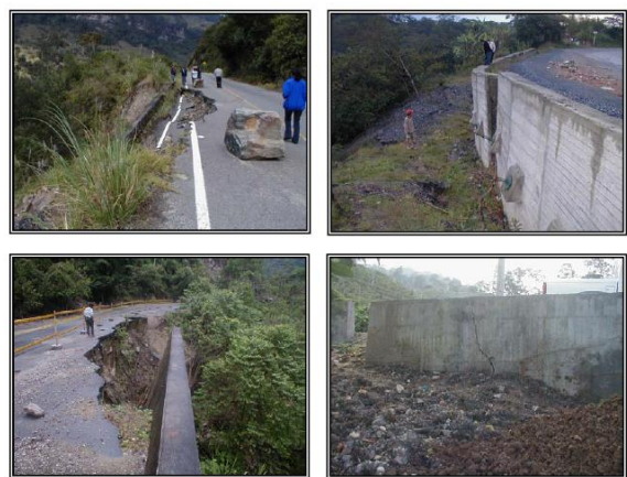
Fig. 4 Daños en Muros de Contención Álvarez (2000)
