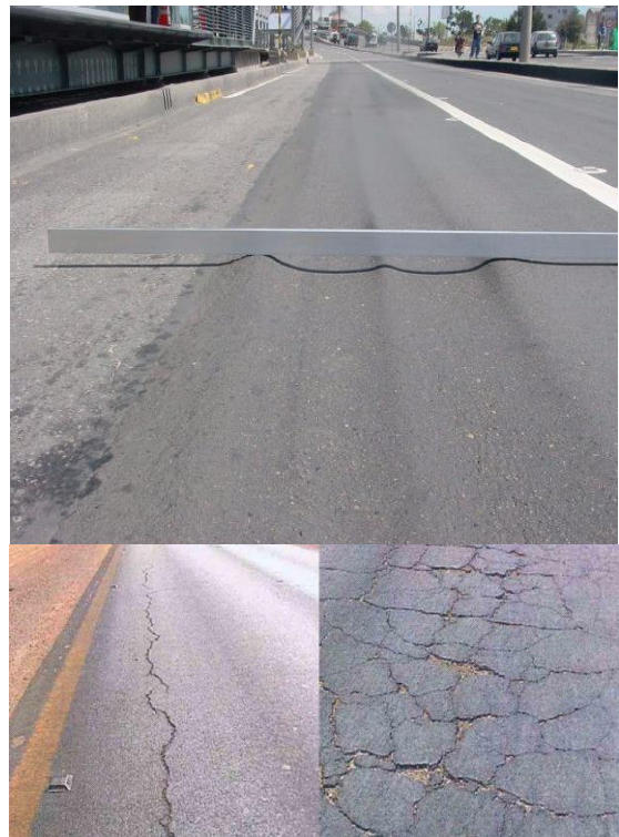
Fotografía No. 1. Deformaciones permanentes en pavimentos flexibles. A la izquierda un asfalto que muestra ahuellamiento, la fotografía central falla debido a repeticiones por carga y a la derecha fatiga llamada también piel de cocodrilo. (Rondón 2012).
