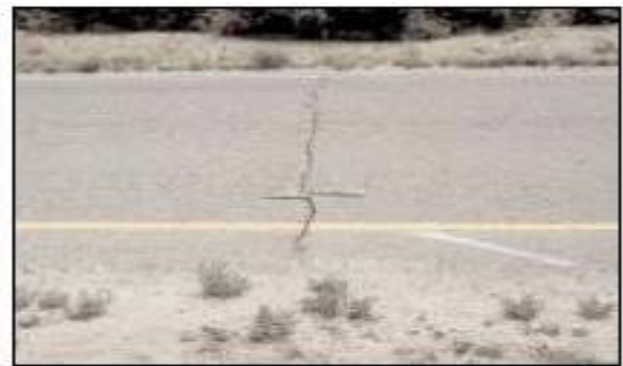
Fotografía No. 4. Agrietamiento por baja temperatura (Rondón 2012).
