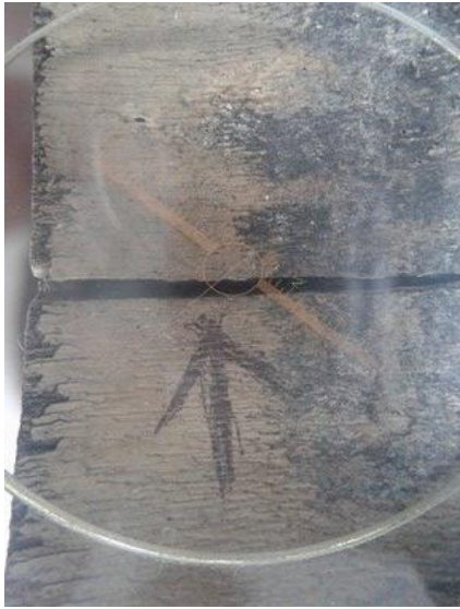
Ilustración 15 Muestra de lesión por fisura
