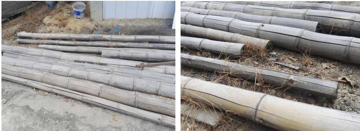
Ilustración 12 Guaduas en estado de fotodegradación con presencia de grietas y fisuras.
