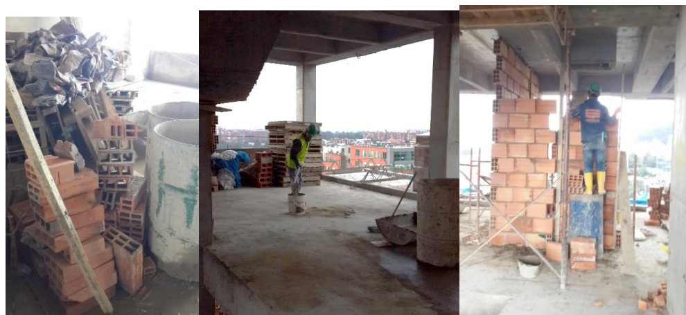
Figura 44. Disposición de innecesarios, limpieza del sitio de trabajo y ejecución mayor a 1.50.
