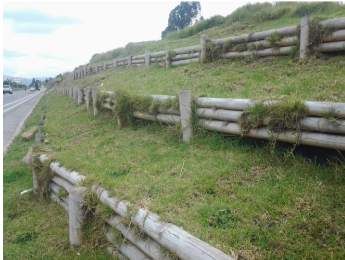
Fotografía 11. Talud N°3 Trinchos de Guadua en buenas condiciones estructurales. Fuente: Propia
