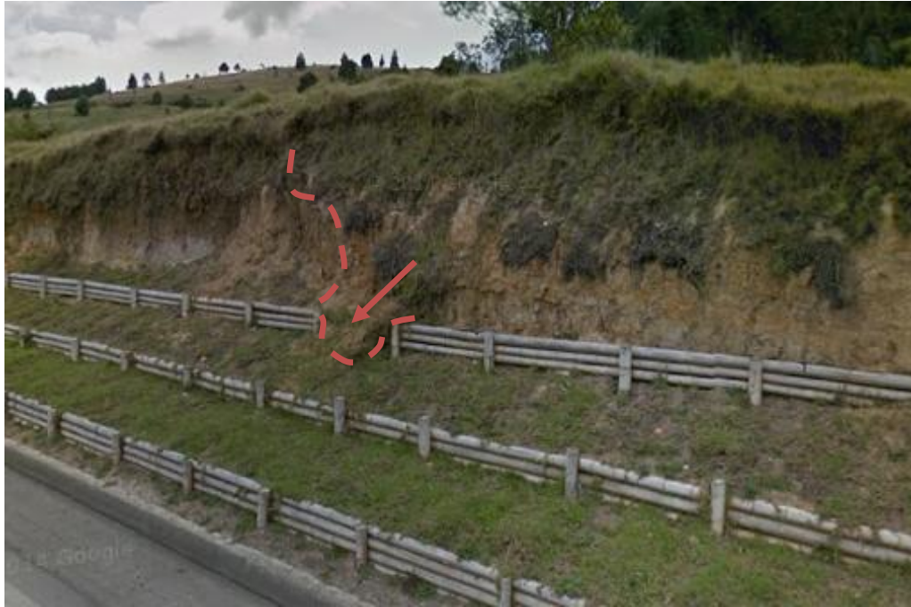
Fotografía 18. Proceso de Remoción en Masa sobre Talud N°4 (Sept. 2013) Fuente: Propia
