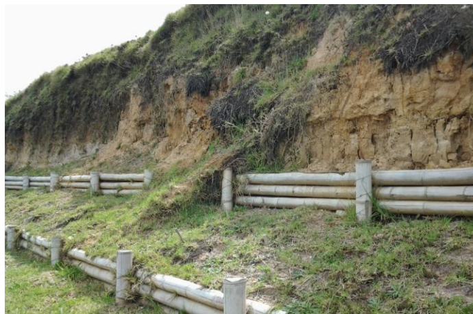
Fotografía 12. Talud N°4 visualmente con problemas de control y presencia de Fenómeno de Remoción. Fuente: Propia
