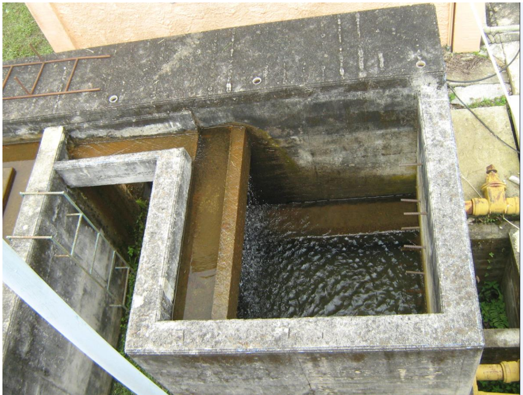
Figura 21 filtro y tubería de conducción para tanque de almacenamiento
