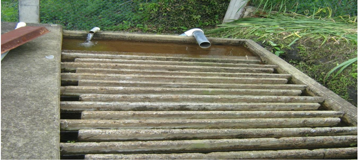
Figura 18 Floculador - tubería de llegada a planta convencional.
