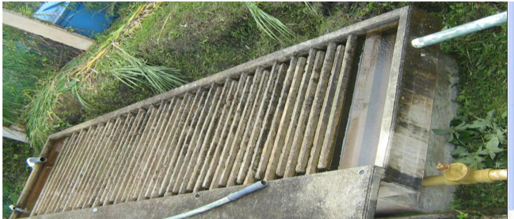
Figura 19 salida de agua floculador para sedimentador
