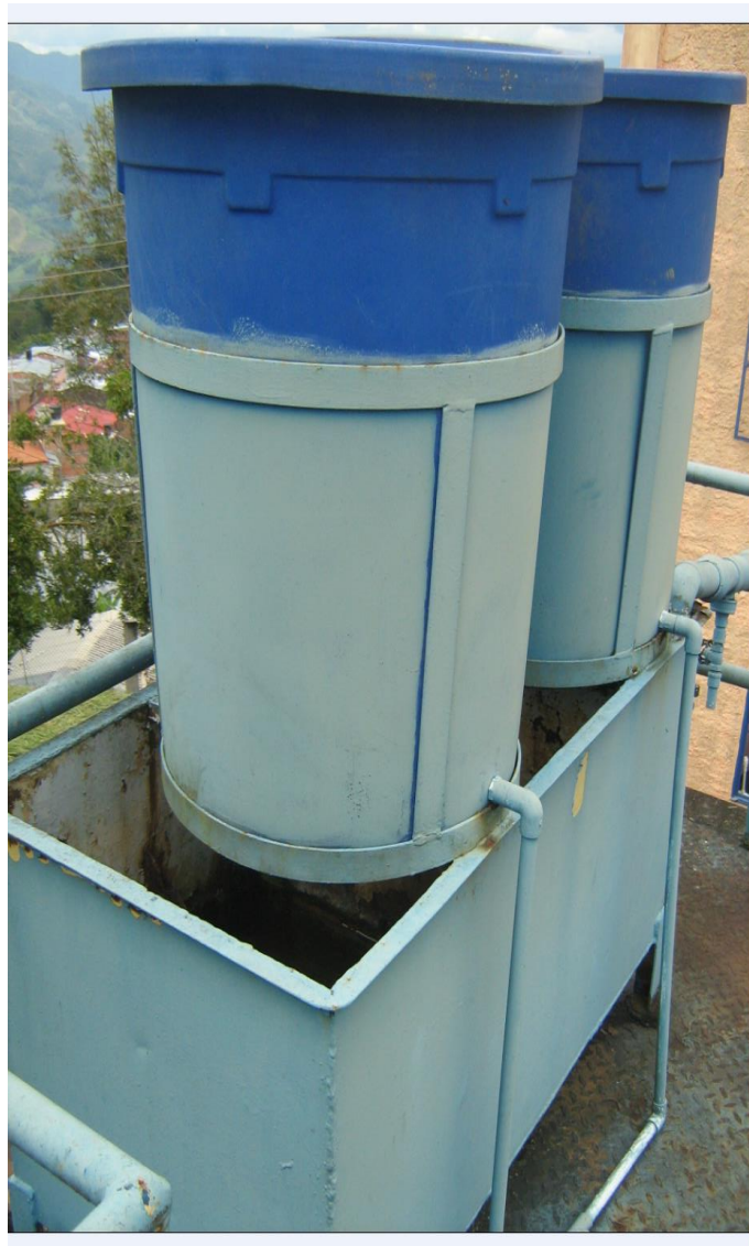
Figura 23 tanque metálico y dos tanques dosificadores
