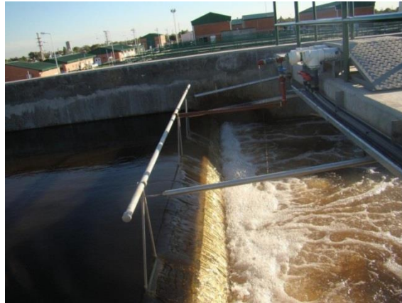
Figura 9. Captaciones en la bocatoma
